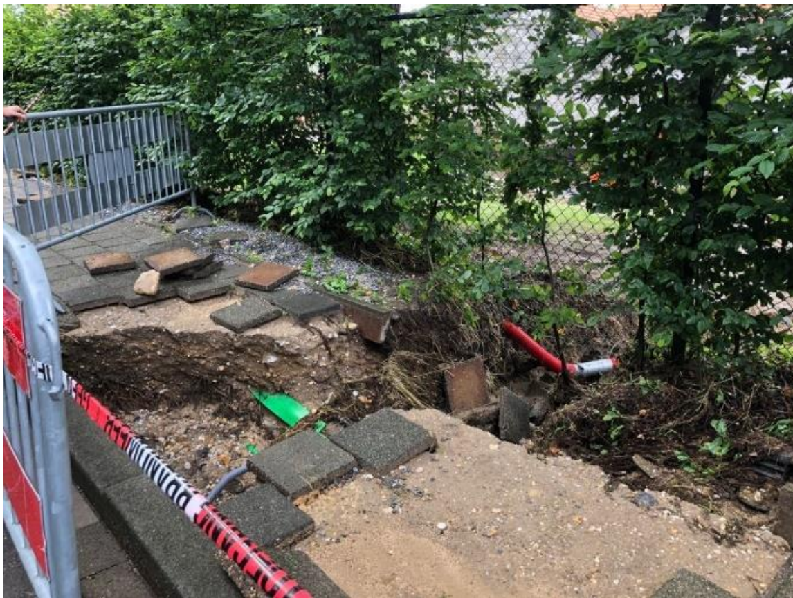
Figuur 10: Schade door afstromend water vanaf de Rimburgerweg naar de lager gelegen percelen aan de zuidzijde (t.h.v. nr. 162).
