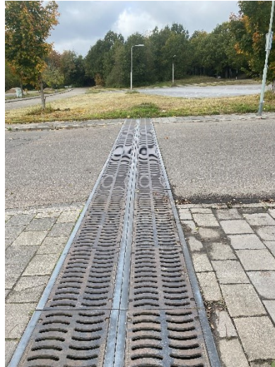
Foto 7. Rooster onder de putstraat
